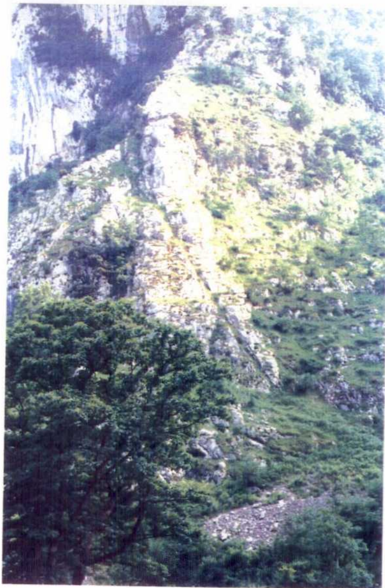
Fotografía nº 10.- Aspecto de la fracturación que afecta a las calizas de la Formación "Picos de Europa" (margen derecho).
